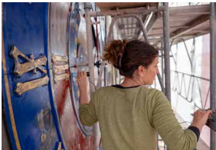
Réalisé en extérieur et à plus de 20 m de haut, le chantier nécessitait des conditions météorologiques favorables.
